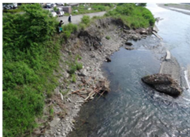
図-4 安芸川国道橋左岸の護岸崩壊状況 (H27. 5. 19 撮影)
