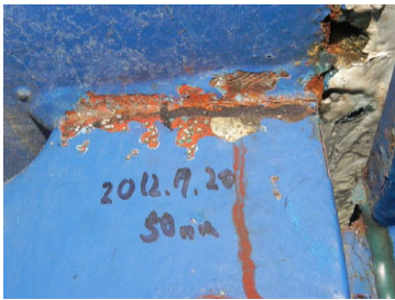
図-2. 溶接止端部の亀裂
