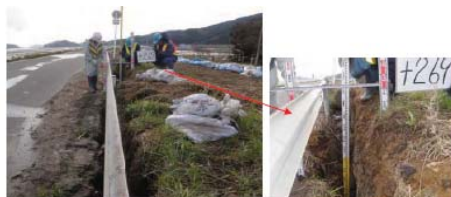
写真1 橋浦地区被災写真 1)
