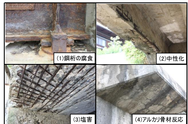
図-1 香川県内市町管理橋梁における損傷事例
