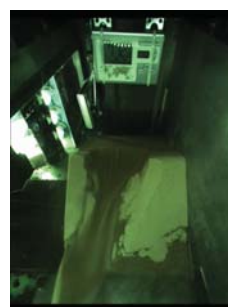
写真2 下流側上部から見た堤体の破壊形態 (CASE4)
