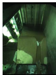
写真1 下流側上部から見た堤体の破壊形態 (CASE2)
