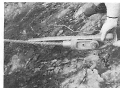
写真1 スリップした緩衝金具
