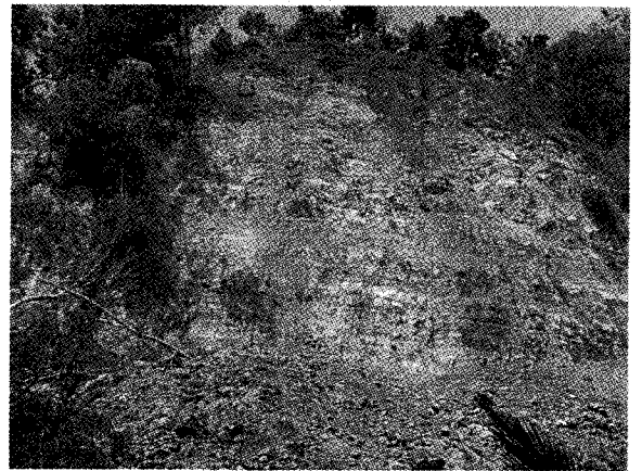
写真-2 地震により発生したがけ崩れ
