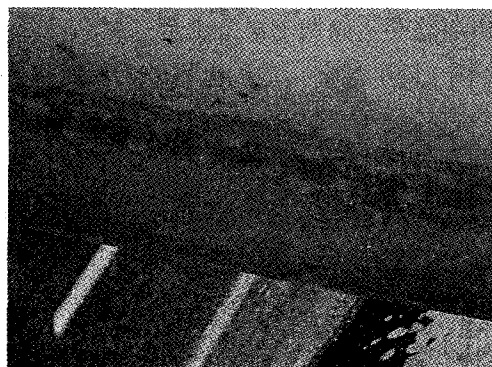
(a) 下フランジ上面の腐食 (PG4)
