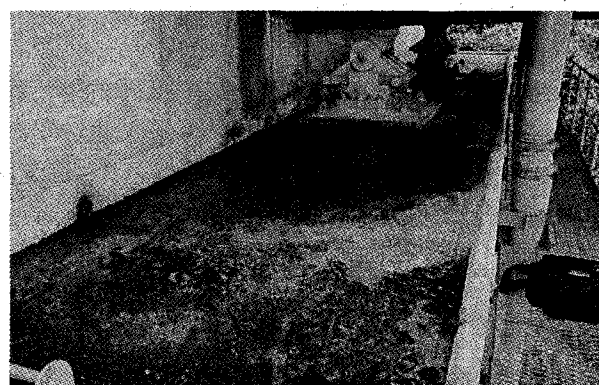
図-4 勾配が不十分で、かつ、水抜き部が詰まり、滞水している橋台
