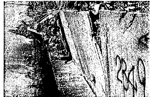
写真-1 崩壊したL型擁壁 (新)
