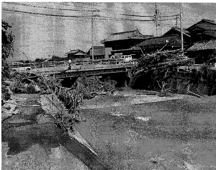
写真-1 妙之谷川の洪水氾濫（妙之谷川橋直上流）
