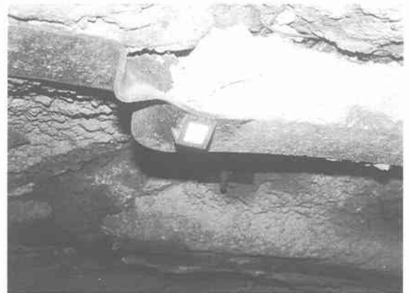
写真 2-1 支保工の変状写真
