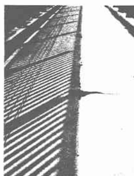
写真-3路面の損傷
