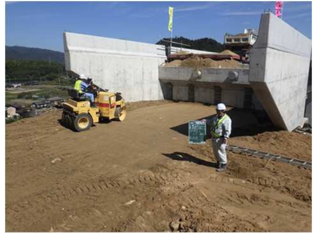
図2 GNSS 転圧管理システムの不具合が生じた状況
