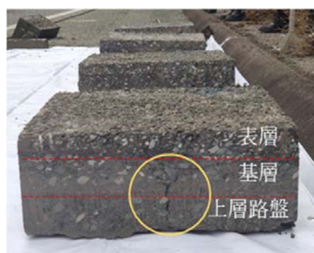
写真-1.2 切出ブロック側面 写真-1 変状状況
