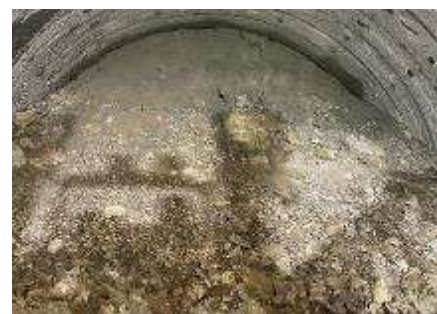
写真-1 TD.319mの天端崩落
