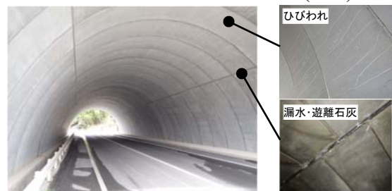
図-6. アーチカルバート(プレキャスト構造)損傷状況
