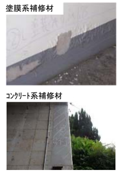
図-13. 補修補強材の損傷例
