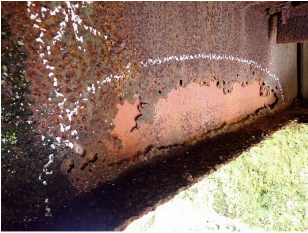
写真-2 主桁端部におけるウェブの貫通孔
