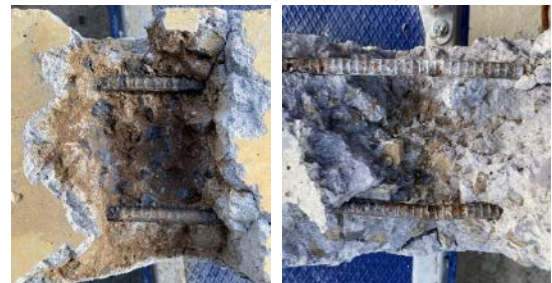
(a)含浸材塗布 (b)無塗布 写真-2 RC はりのはつり面
