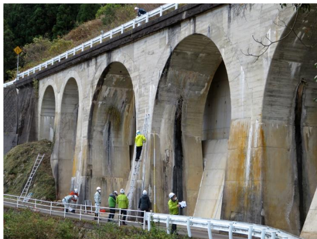
写真-3 県道として拡幅された5連アーチ橋 （現地計測の様子）
