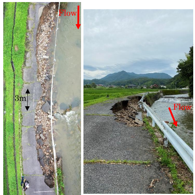
写真-1 2.6k地点での被害箇所②
