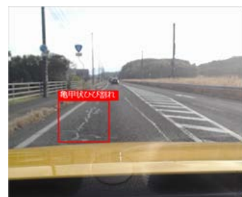
図-8 誤認識の事例 (補修跡をひび割れと認識)
