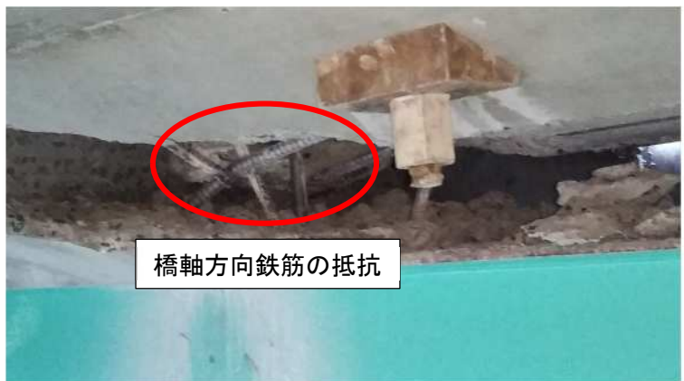
写真-2 床版剥離状況(下面)
