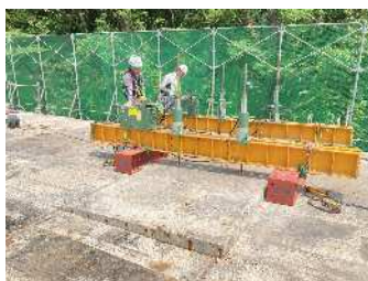
写真-1 既設床版剥離状況
