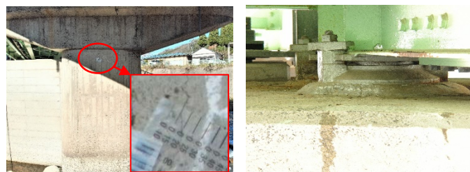
写真-1.ひびわれ検出精度
