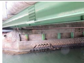
写真-2.洗堀が疑われる橋梁の変状状況
