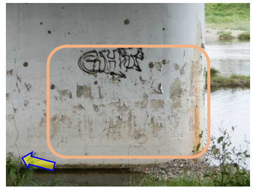
写真 3.1 橋脚劣化状況 (P4 終点側)
