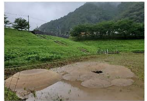
写真-2 令和2年7月洪水時噴砂状況
