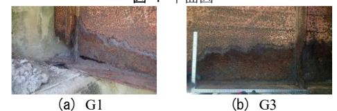
図-2 実橋の腐食損傷
