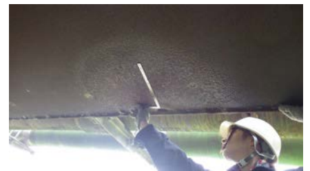
図 2 床版下面の漏水周辺の腐食状況
