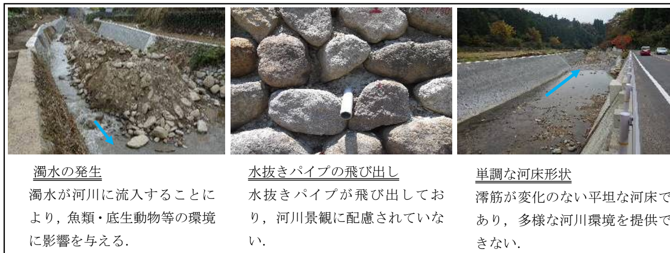
図-4 施工配慮が十分でない箇所
