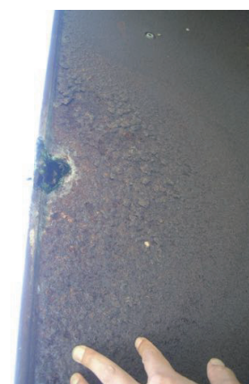
図2 床板下面の漏水周辺の腐食状況
