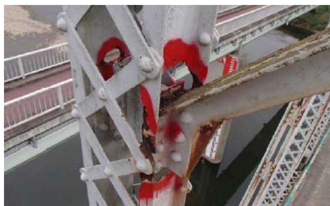
写真-1 鉛直材ウェブの貫通孔
