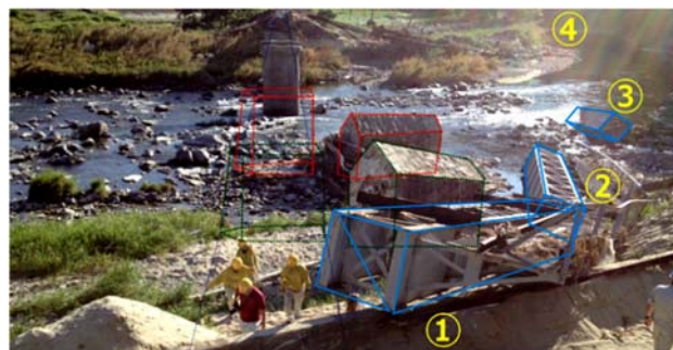
写真-1 旧橋の落橋・流失状況 1)
