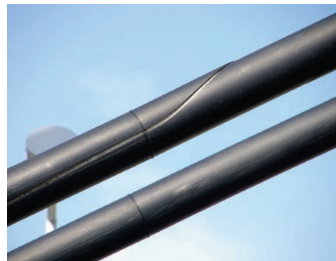
写真－1 斜材保護管の損傷例
