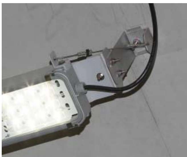
図-7 照明器具取付，落下対策
