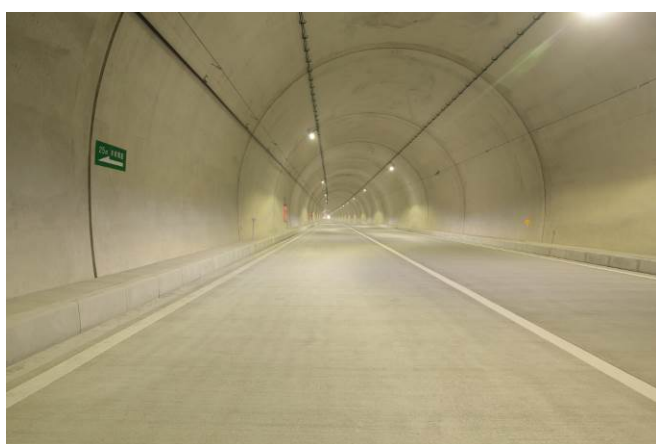
図-6 トンネル内照明点灯状況（基本照明）
