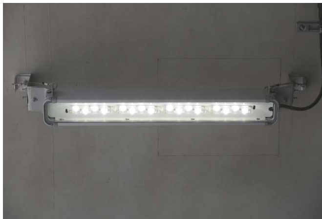
図-3 直流給電方式用トンネル LED 照明器具
