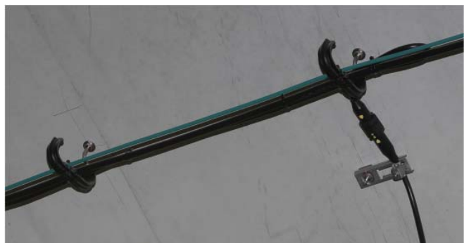
図-4 照明配線 (幹線, 分岐部)
