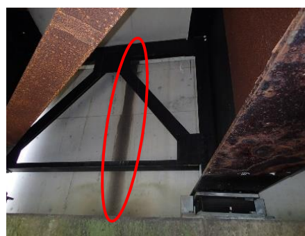
図-6 伸縮装置からの漏水
