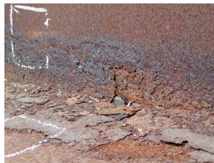
図-4 I-1 の腐食例(層状剥離さび)
