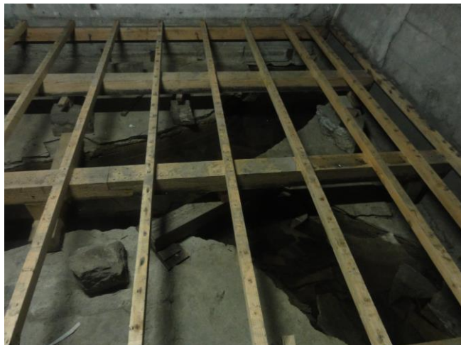
図 3 指揮連絡室の床の様子
