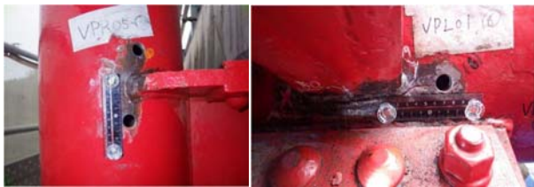
写真-1 亀裂状況（ストップホール削孔後）
