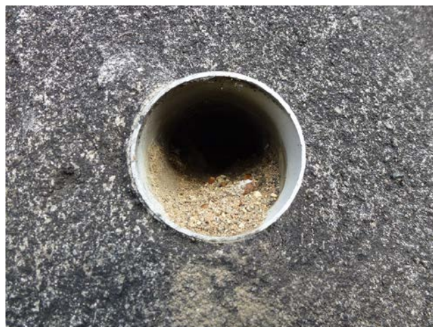
図-6 背面から流出し水抜き穴に堆積する土砂
