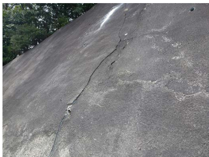
図-8 段差を伴う亀裂（青色の亀裂）
