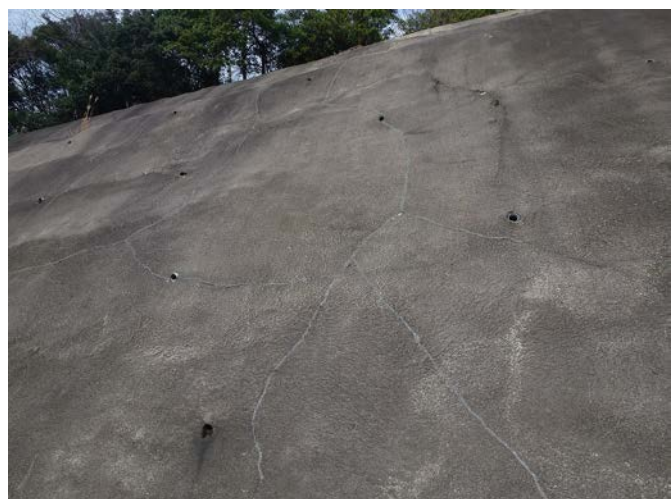
図-9 開口亀裂（赤色の亀裂）
