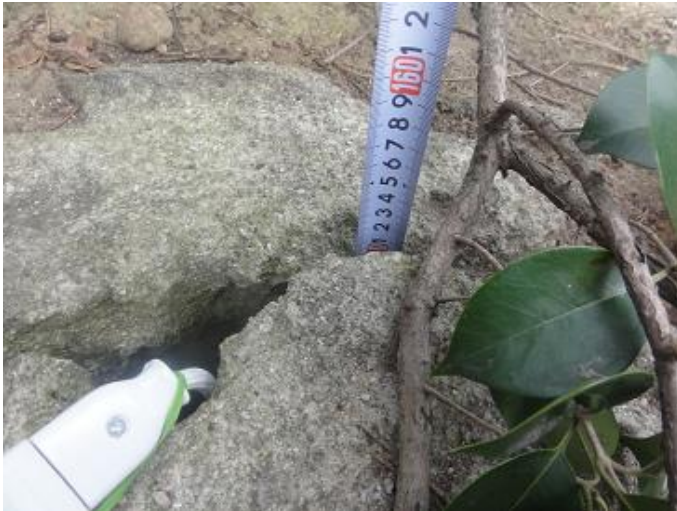
図2 今回新たに見つかった亀裂
