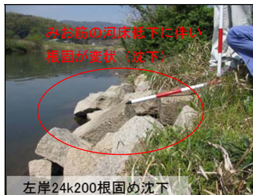
写真2 根固めの変状 (24.2k 左岸)
