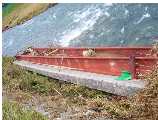
写真-1 H21.8.9 豪雨による流橋被害事例
