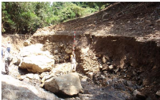
図 2 浸食深さの例(八木ヶ丘団地, 浸食深さ約 4m)
