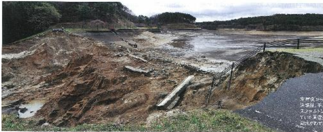
写真 1 藤沼ため池堤体決壊写真 2)
