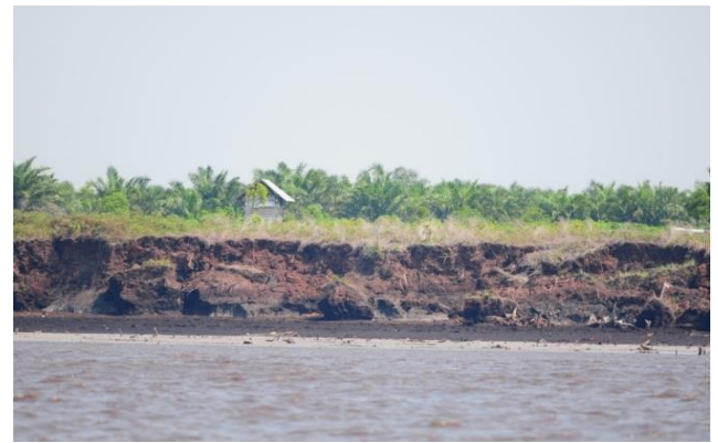
図-2 ブンカリス島北西部の海岸侵食状況
