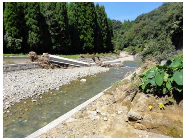
写真 2 敬川上流の橋桁流失
