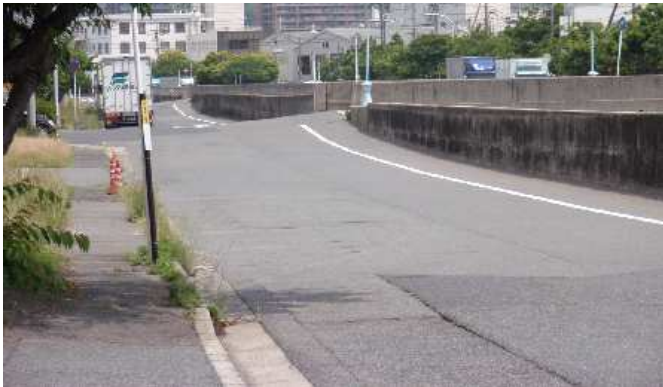
写真 1 橋と道路の不同沈下
