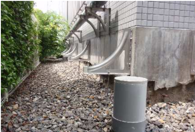
写真 2 不同沈下で基礎が露出した建物
