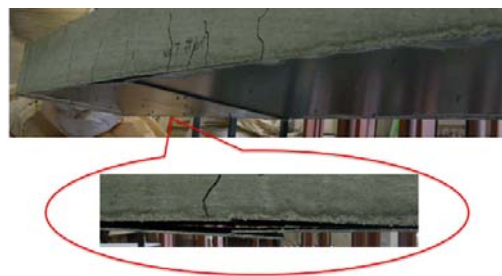
写真 - 4 鋼板折曲げの底鋼板の剥がれ（配力筋方向）
