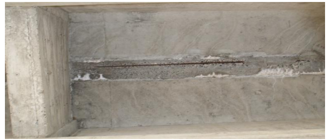
写真-1 遊離石灰の損傷写真の一部
