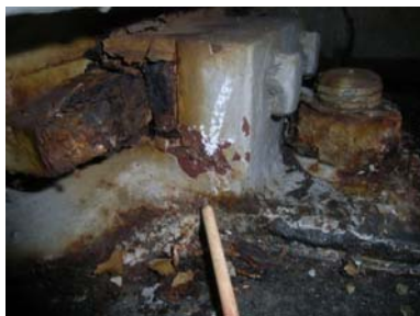
写真－1. 沓座破損状況
