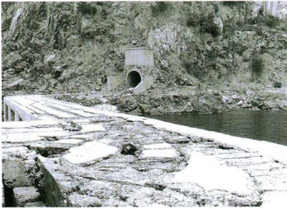
図-3 トンネル出口（補修前） 4)
